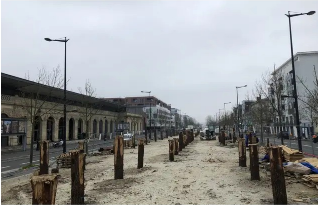
Des poteaux ont été installés pour les fondations de la villa Shamengo sur l'Allée Serr, à Bordeaux. — E.Provenzano / 20 Minutes
